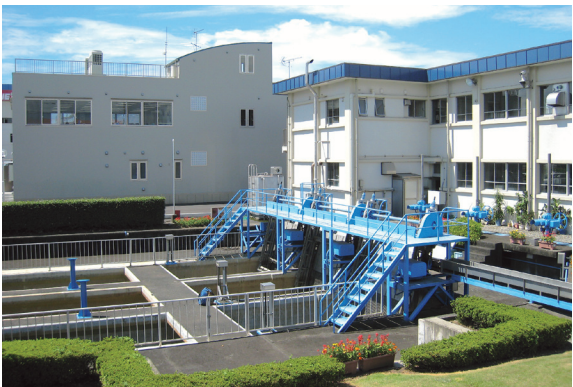
今泉ポンプ場
